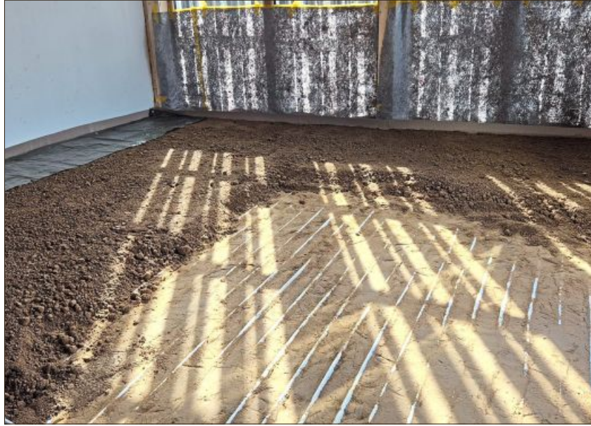
Hier wird der Aufbau des Lehmbodens gut sichtbar: Die Rohre der Fußbodenheizung befinden sich in einer feinen Lehm-Sand-Mischung, darauf folgt eine gröbere Schicht, die noch festgestampft werden muss.
